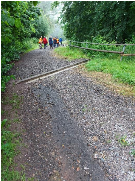
Abbildung 14 Erlenbrunn, ausgespülter Wirtschaftsweg unterhalb des Friedhofes
